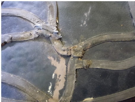
Verfuschte frühere Sanierung
